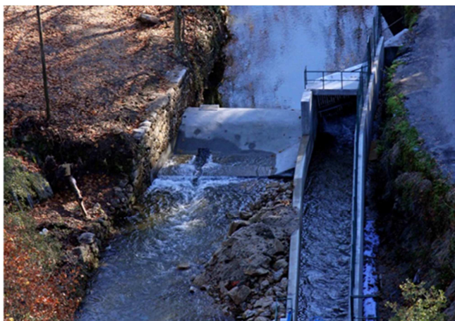
Figura 8. Açude e tomada de água da CMH do Lourido.
