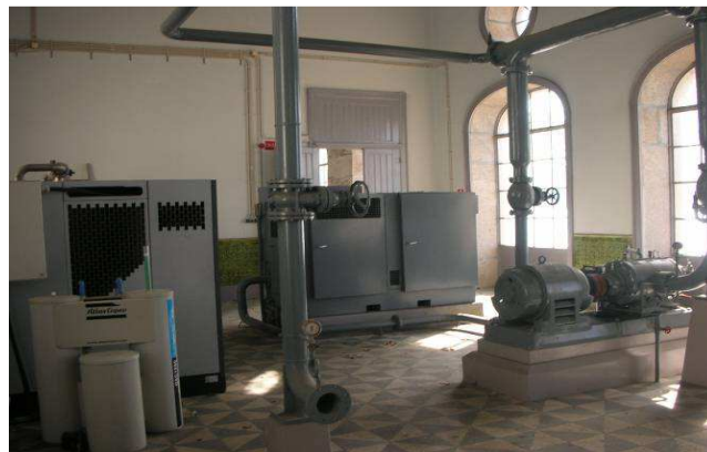
Figura 25. Sobreiras – Pormenor da sala de compressão.
