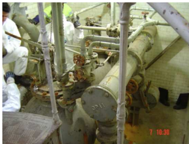
Figura 27. Ejector do Largo do Calém – pormenor do equipamento e circuitos.
