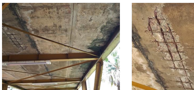
Figura 9. Placas pré-moldadas apresentando manchas, deslocamentos, eflorescências, corrosão da armadura, desagregação e presença de umidade. Fonte: De autoria própria.
