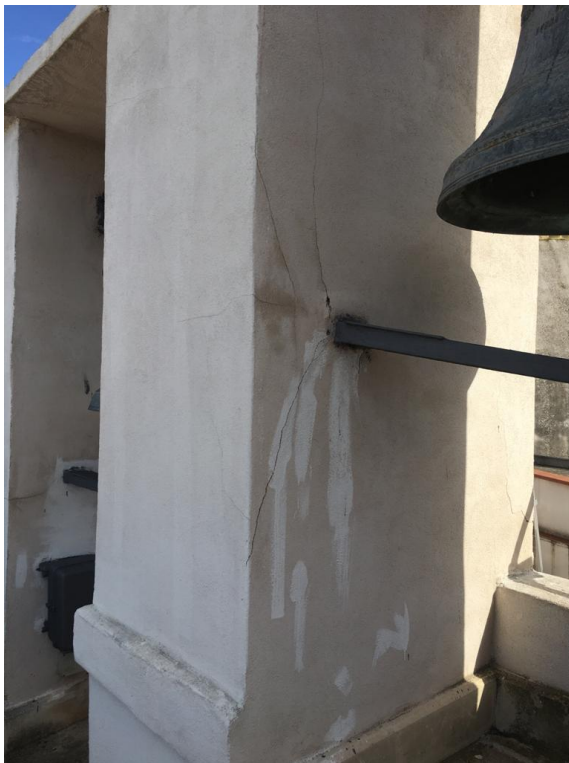
Figura 5. Lesioni del campanile a vela
