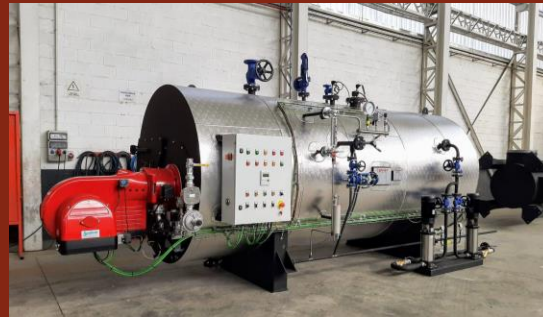
Caldeira a vapor (Cerney, 2023)
