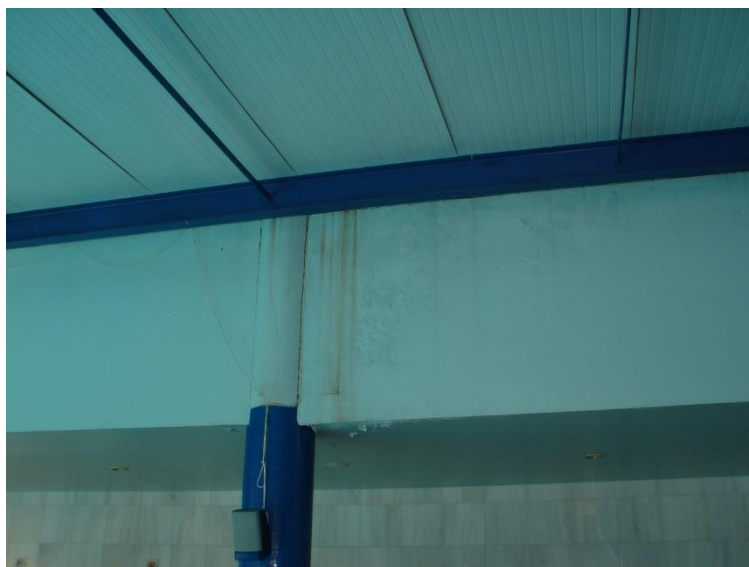
Figura 5.26 – Infiltração no teto da piscina interior
