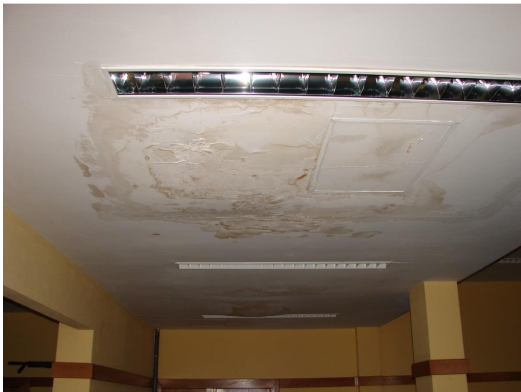
Figura 5.23 – Infiltração da piscina activa do spa para o ginásio
