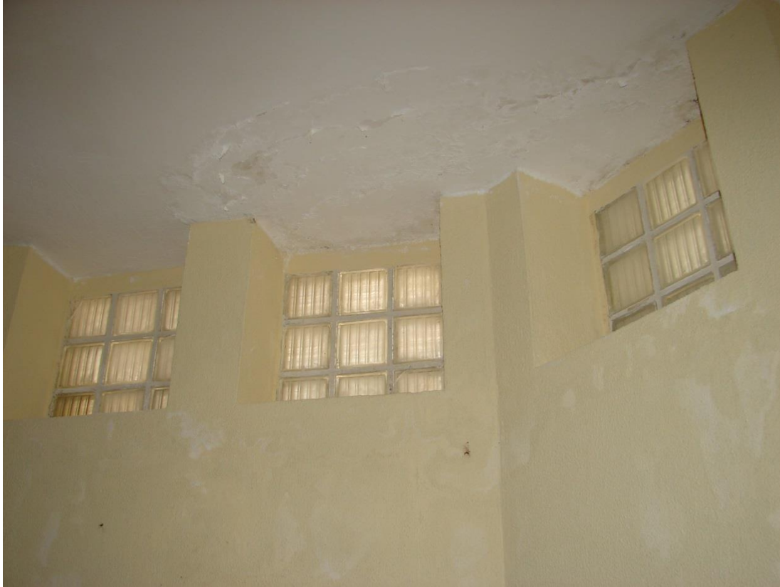
Figura 5.24 – Infiltração num corredor de acesso do hotel
