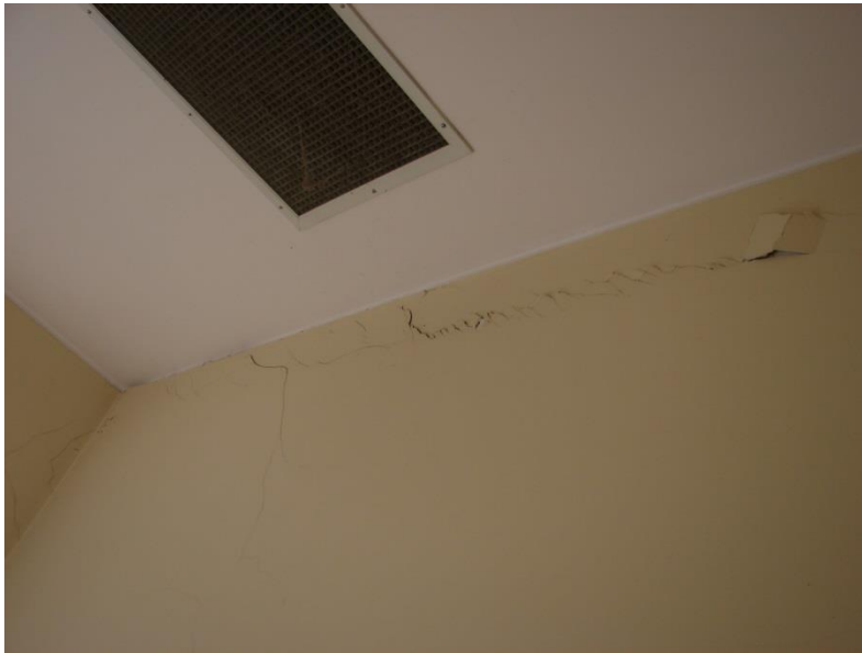
Figura 5.28 – Fissuras em várias paredes do hotel
