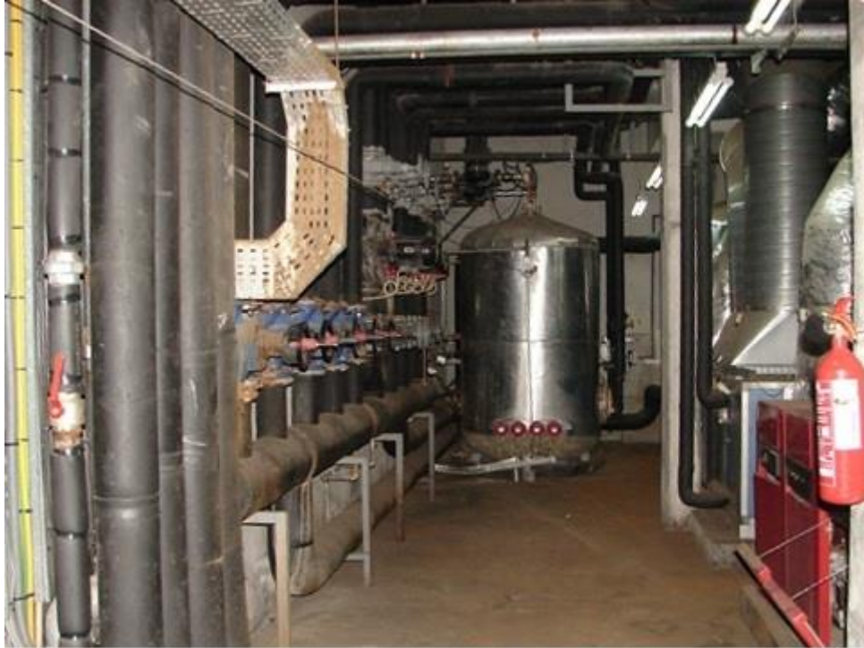
Figura 5.30- Casa das caldeiras do hotel
