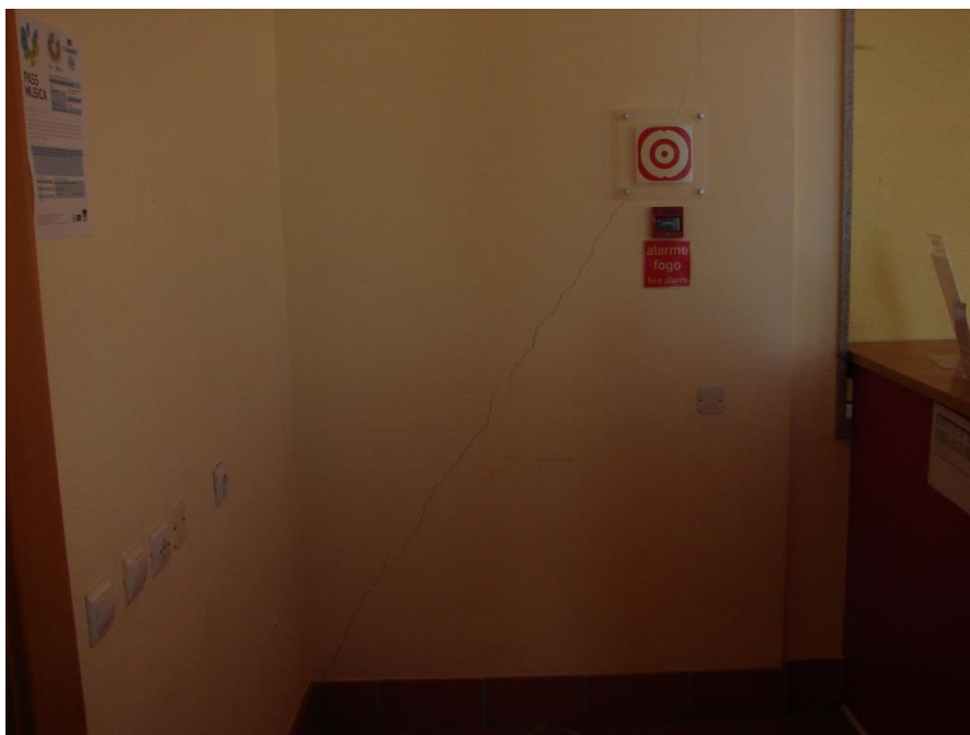
Figura 5.29 – Fissuras em várias paredes do hotel
