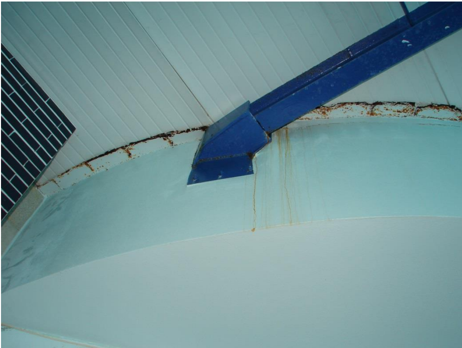
Figura 5.25 – Infiltração no teto da piscina interior
