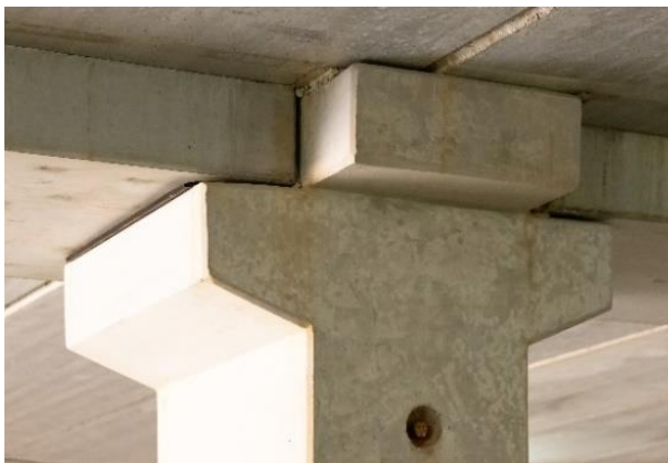
Figura 19. Consola curta aparente no piso de estacionamento.
