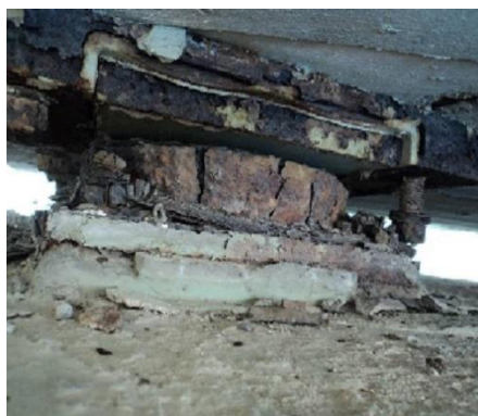
Figura 5. Ilustração do aspeto dos aparelhos de apoio do tabuleiro relatado no RIP de 2011 [3].
