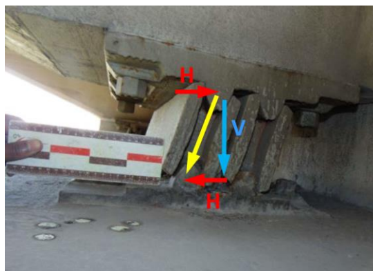
Figura 7. Comportamento dos aparelhos de apoio do tabuleiro nas pilastras.
