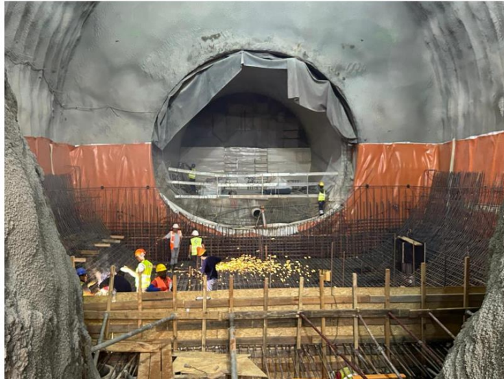
Figura 13. Estado atual dos trabalhos de construção no interior da Nave Central, lado Norte.
