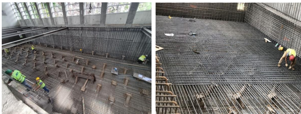
Figura 10. Laje de fundo da central. Fim da instalação de microestacas inclinadas e montagem de armaduras da laje e paredes monolíticas em betão armado estrutural, para acomodação dos novos grupos.
