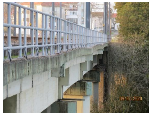
Figura 6. Ondulação observada na estrutura do tabuleiro devido ao levantamento das vigas pré-esforçadas.
