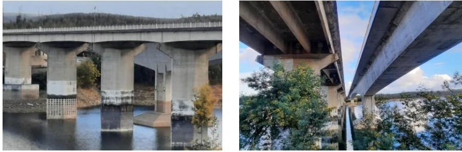
Figura 1. Ponte sobre a foz do rio Dão: estrutura antiga, afetada pelas expansões do betão, e a nova ponte, com tabuleiro em caixão.
