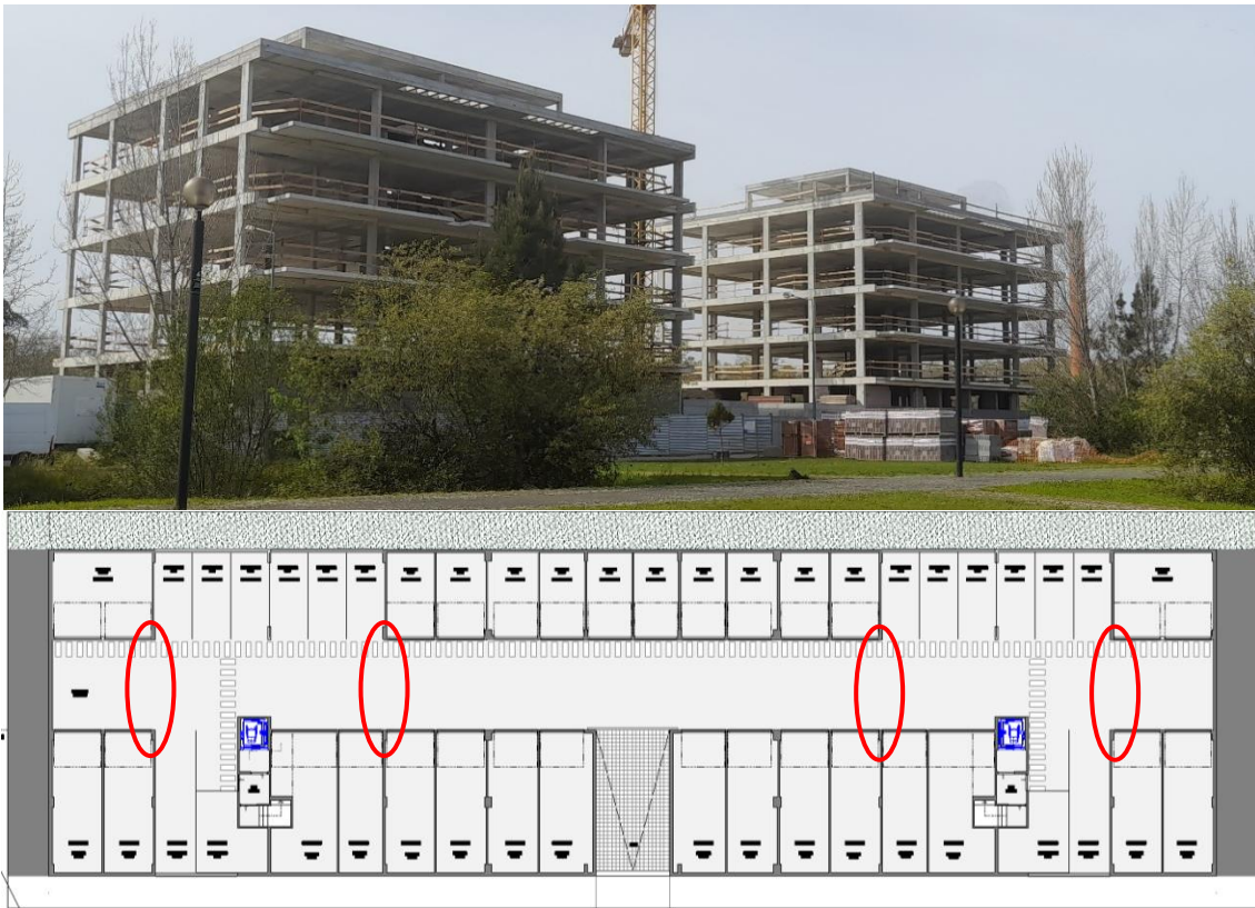
Figura 2. Planta geral da cave - localização dos pórticos com vigas fissuradas.
