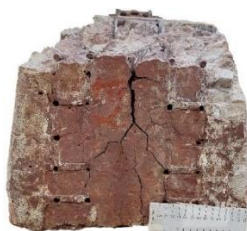
Figura 12. Estado visual de deterioração da extremidade do grupo G1. (Fonte:Autores).
